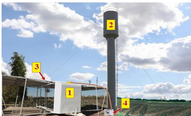
Рис-3. Мобильная «Солнечно-ветровая» электростанция в работе: 1- мобильная «Солнечно-ветровая» электростанция; 2 – артезианский колодец; 3 – солнечные панели; 4 – щит управления системой
